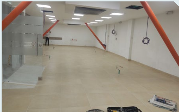
Figura 227. Adecuaciones y cambio de piso en la sala de docentes del Bloque B
