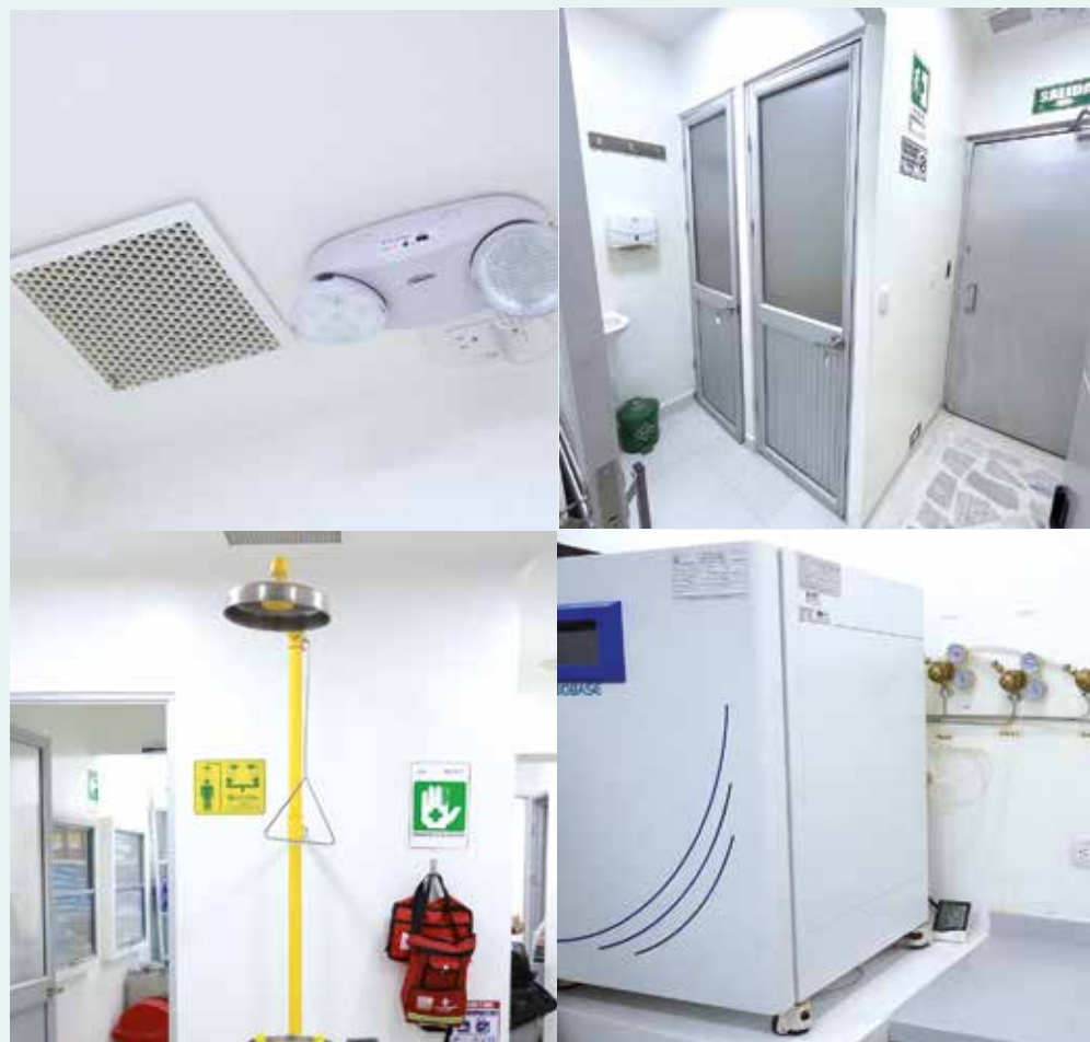
Figura 210. Adecuaciones, suministro e instalaciones para el Laboratorio de Reproducción y Sanitario de la sede Quirinal - CORHUILA.
