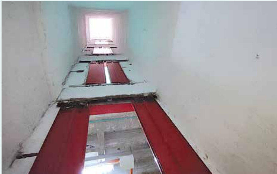
Figura 213. Adecuación foso y obras eléctricas para ascensor y cuarto de máquinas bloque C, sede Prado Alto.
